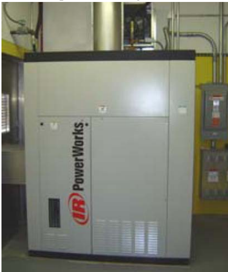
Ingersoll Rand Microturbine
