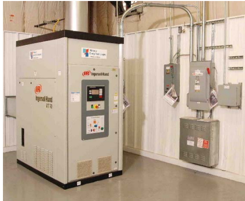
MT70 Ingersoll Rand Microturbine
