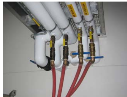
Conduits for propylene glycol/water coolant
